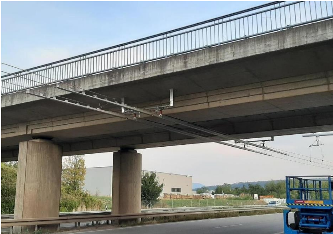
Abbildung 3: Stromschiene am Überführungsbauwerk K 3714
