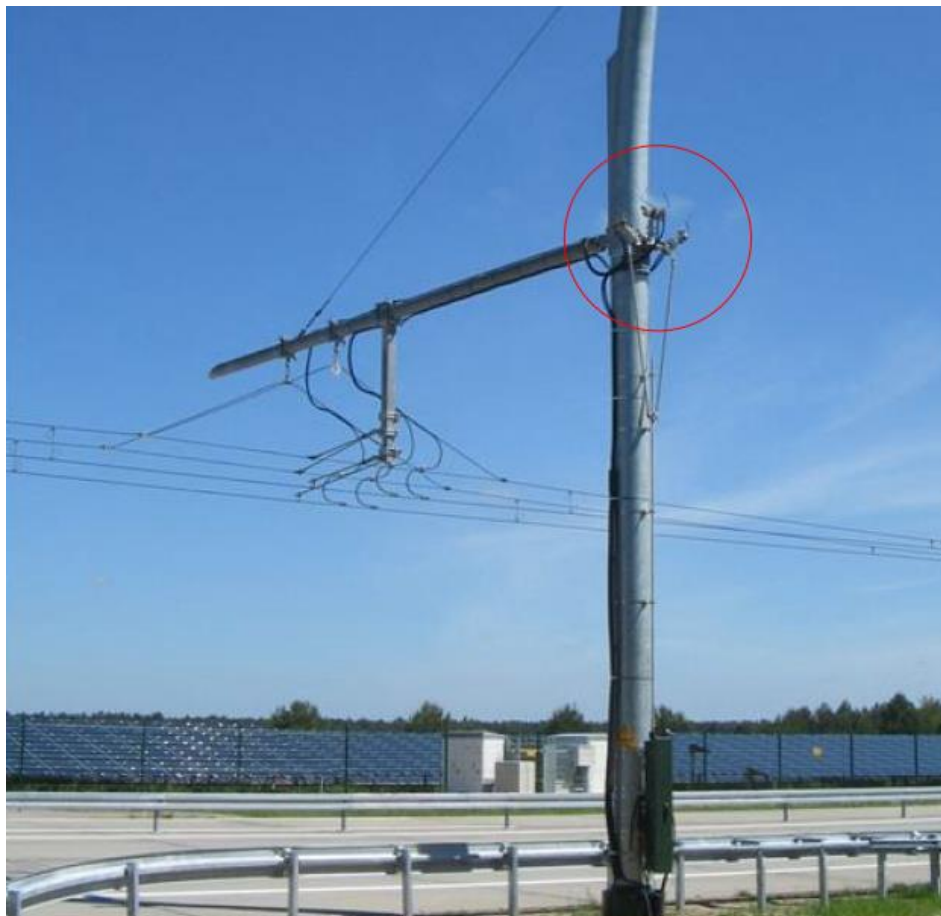
Abbildung 7: Erdungsmasttrennschalter an einer Einspeisestelle
